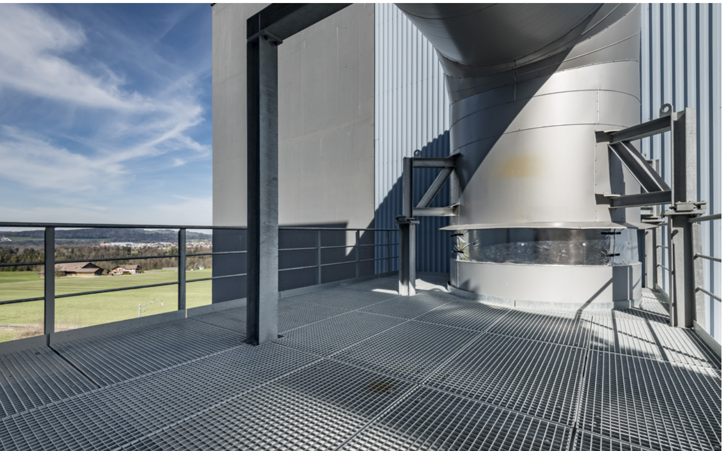
Rund 2500 m 2 Gehflächen aus feuerverzinkten Gitterrosten. Environ 2500 m 2 de surfaces praticables en grilles caillebotis zinguées à chaud.
