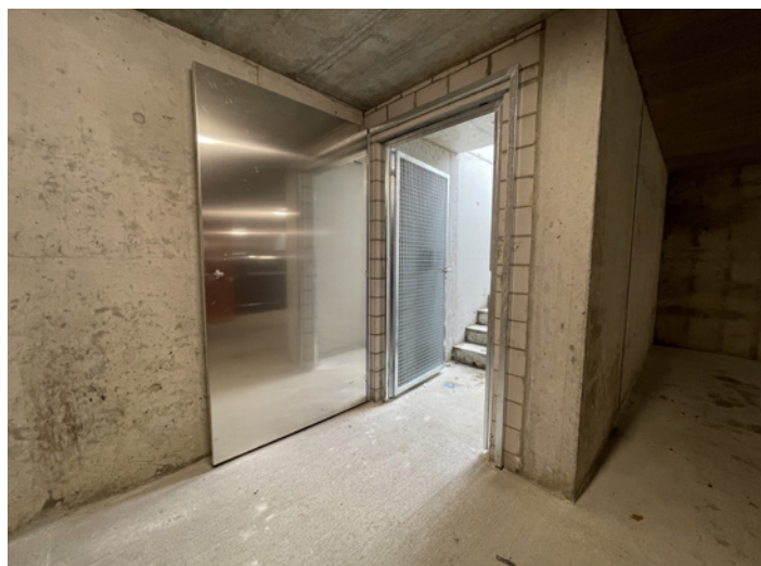
Sicht von innen: Links die Rauchklappe, rechts die Gitterrost-Türe.
